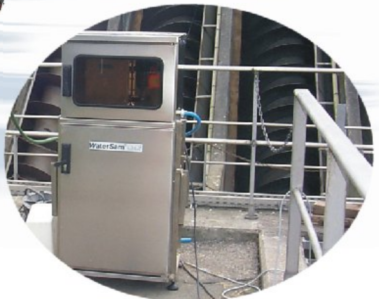
Belgio Ingresso impianto trattamento acque reflue
