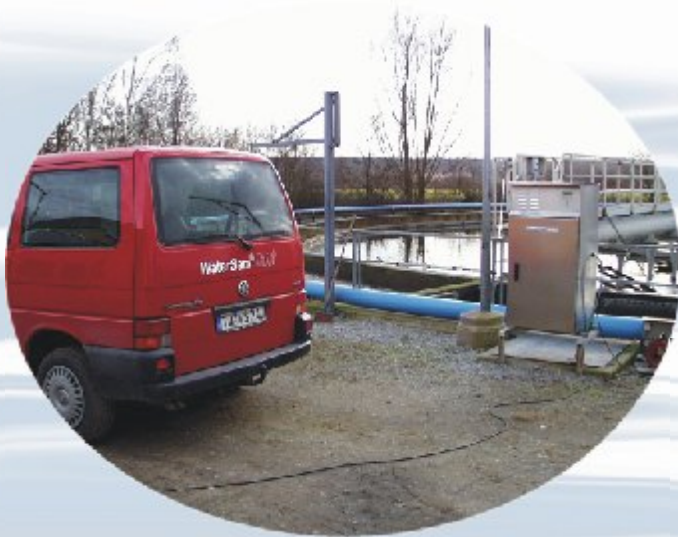
Germania Uscita impianto trattamento acque reflue
