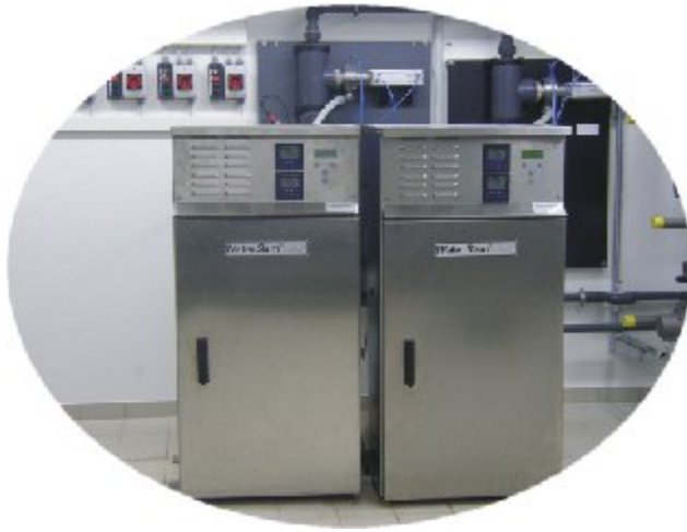
Germania Stazione di pompaggio
